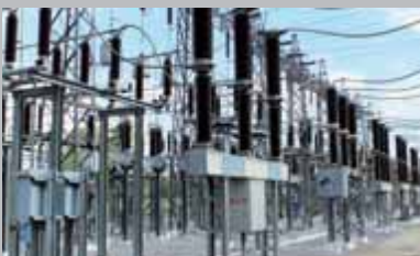
Proyecto subestación eléctrica. Qatar QEWC Electrical substation Qatar project QEWC
