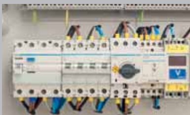
Amplio espacio para el cableado Wide space for the cabling
